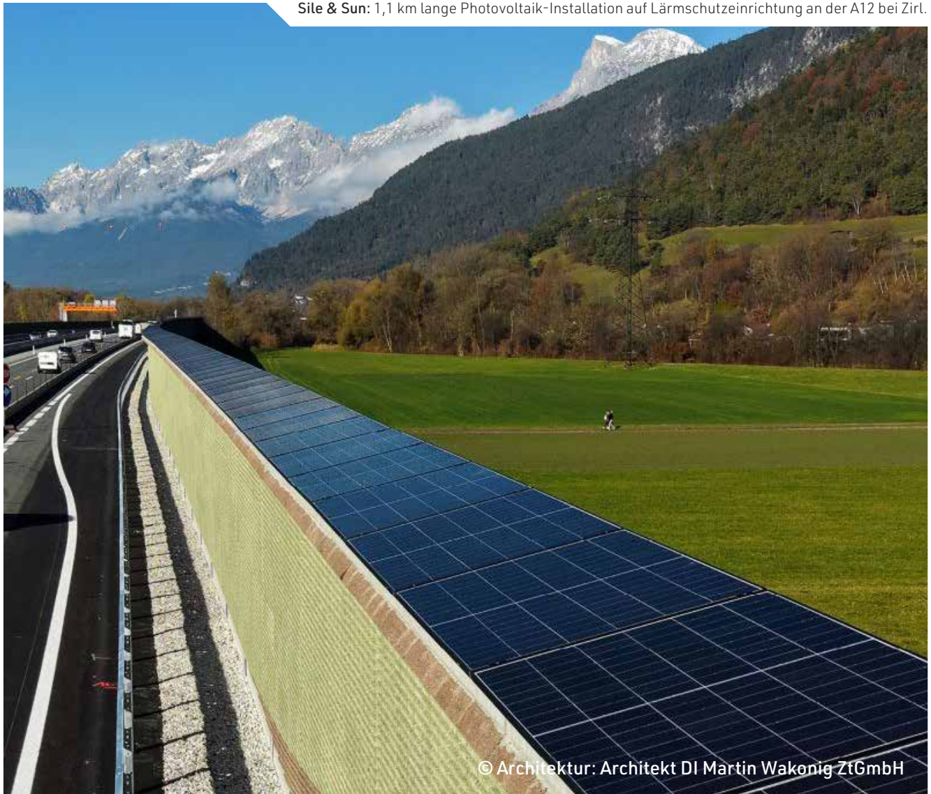
Site & Sun: 1,1 km lange Photovoltaik-Installation auf Lärmschutzeinrichtung an der A12 bei Zirl.
